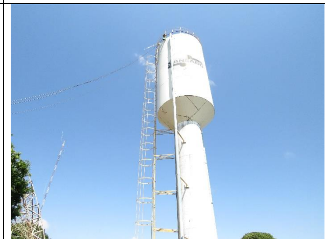
Autor: AMAE Descrição: REL em condições adequadas.
