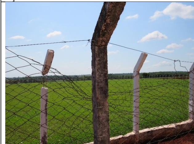
Autor: AMAE Descrição: Partes da cerca que cederam.
