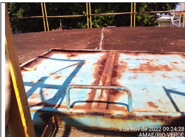
Autor: AMAE Descrição: Tampa de inspeção do RAP com indícios de corrosão.
