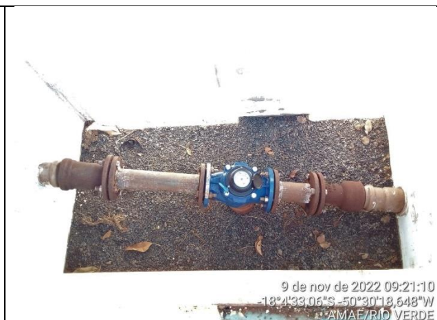
Autor: AMAE Descrição: Macromedidor.
